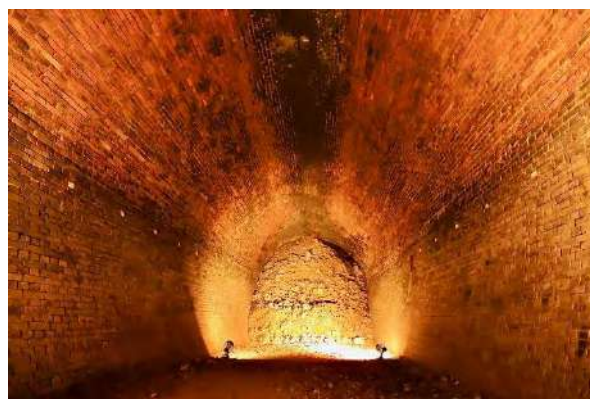
亀の瀬トンネルの崩落面
