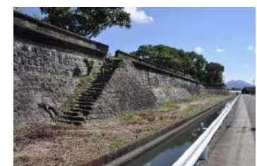
海辺：5.2km連なる旧玉名干拓施設の一部 明丑開潮受堤防
